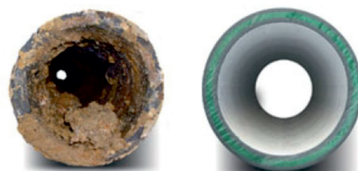
Tubo de acero Degradación en 5 años
