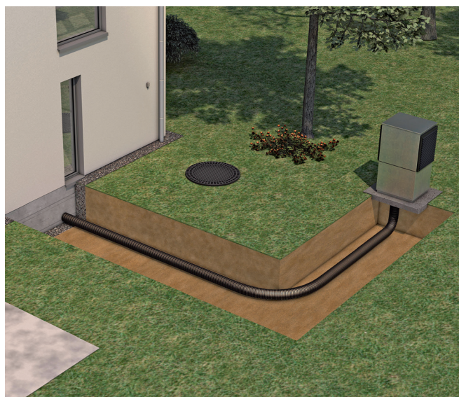
Collegamento con Ecoflex Thermo Twin HP tra una pompa di calore esterna e un edificio residenziale
