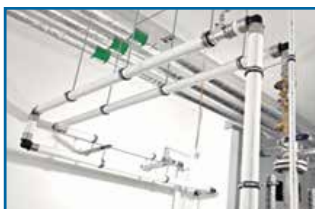
Distribuce teplé a studené vody
